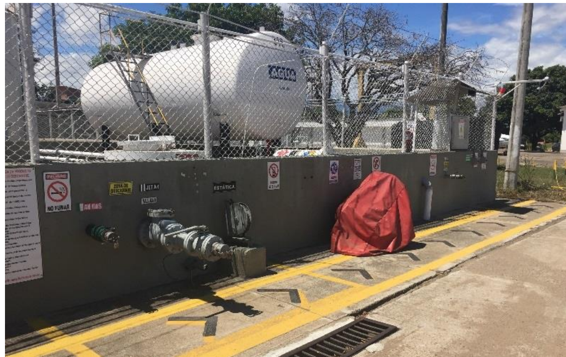
Imagen 2.10. Zona de llenado de carrotanques
